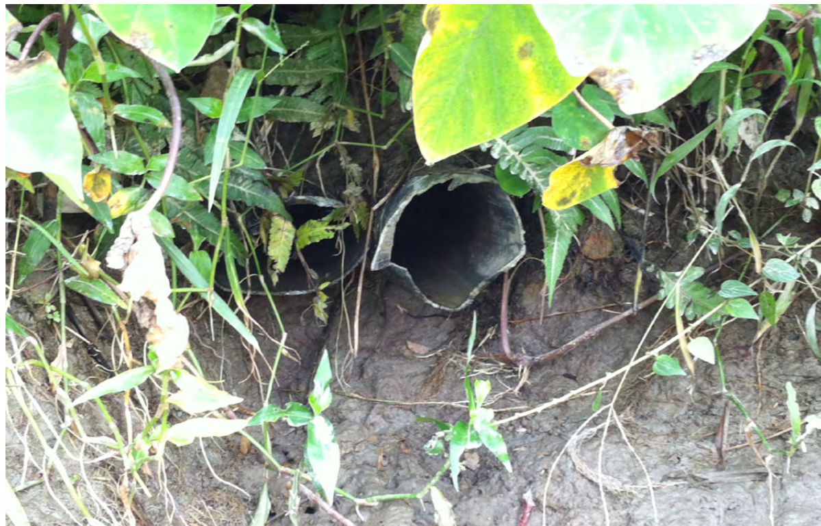
Image 4 : Une prise directe illégale dans la digue d'un canal. Cliché : R. Valadaud, 2017.
